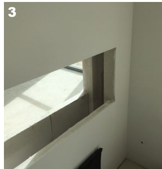
3 Pejsevæggen er ikke sikret mod falsk træk i siderne.
