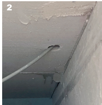
2 For stort et hul omkring ledningshullet, skulle have været fuget.
